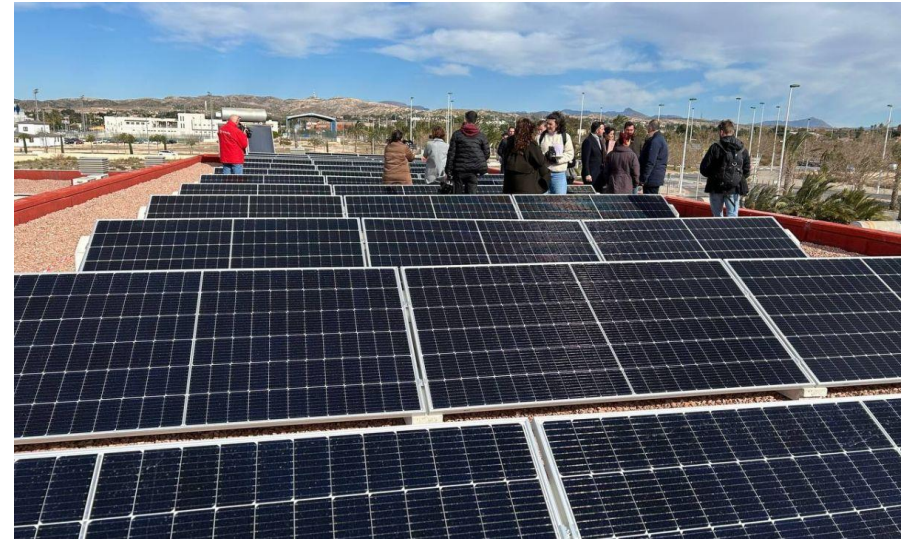
Placas solares en colegios públicos. Ayuntamiento de Elche
